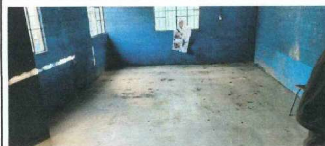
Foto 5: Repello de paredes de aula 1, interior
